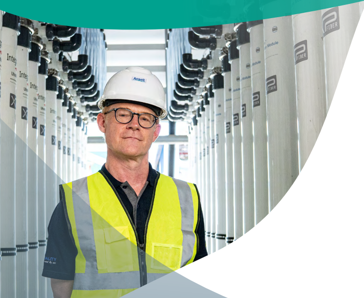
Neil se ocupa de la planta de ósmosis inversa, instalada en nuestra fábrica de Tailandia.
